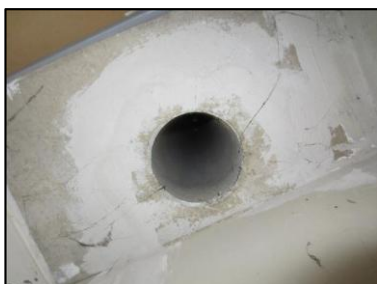
Photo N° 1198 AMIANTE CIMENT -- placards technique gaz +3 Conduits Ventilation haute (Fibres-ciment)
